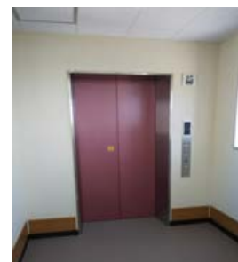
本館西側エレベーター
